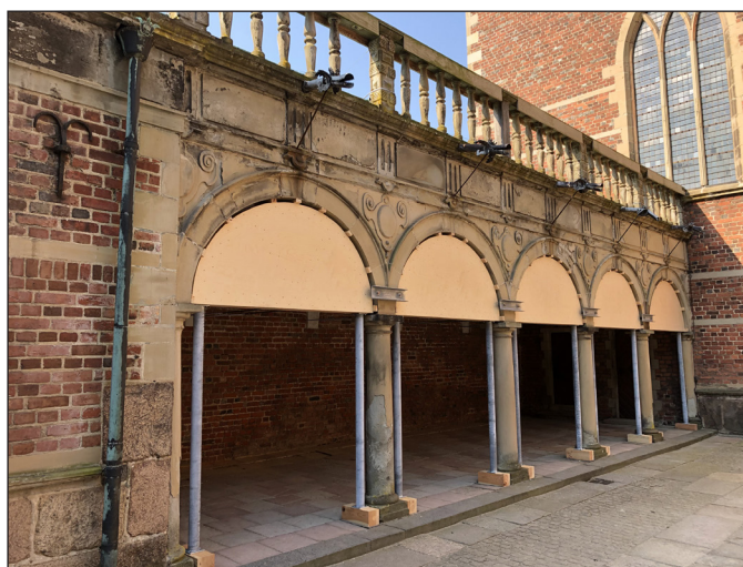
Frederiksborg Slot. Smuldrende sandsten understøttet af trækonstruktion. Foto: Alex Ahrendtsen
